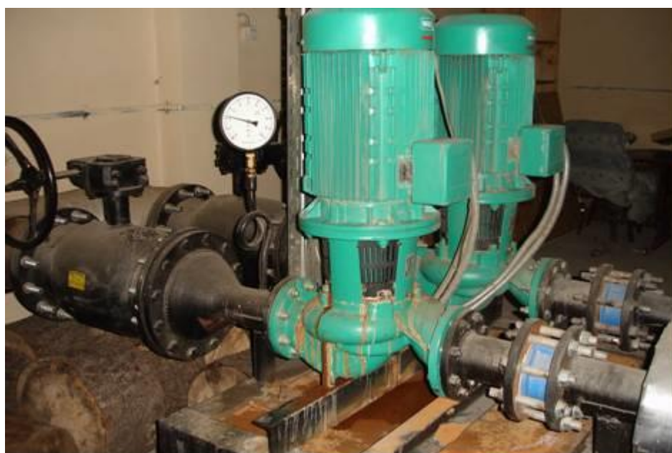
Figura 2.10. Principala sursa a pierderilor din PT1: una din pompele de circulație
