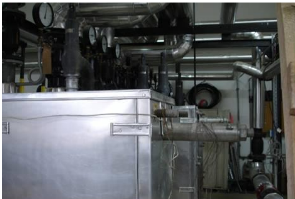
Figura 2.15. Starea echipamentelor/gradul de uzură al echipamentelor din PT3
