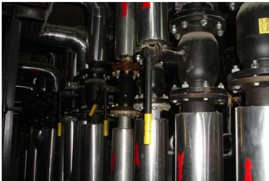
Figura 2.9. Starea echipamentelor/gradul de uzură al echipamentelor din PT1
