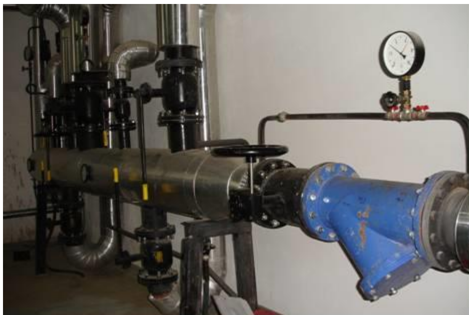
Figura 2.16. Starea echipamentelor/gradul de uzură al echipamentelor din PT3
