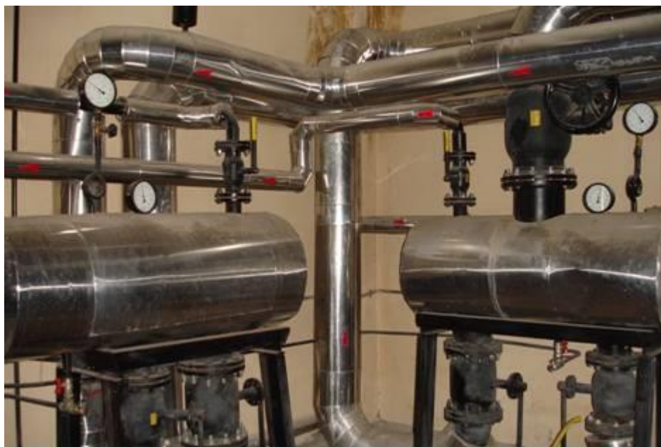
Figura 2.12. Starea echipamentelor/gradul de uzură al echipamentelor din PT2
