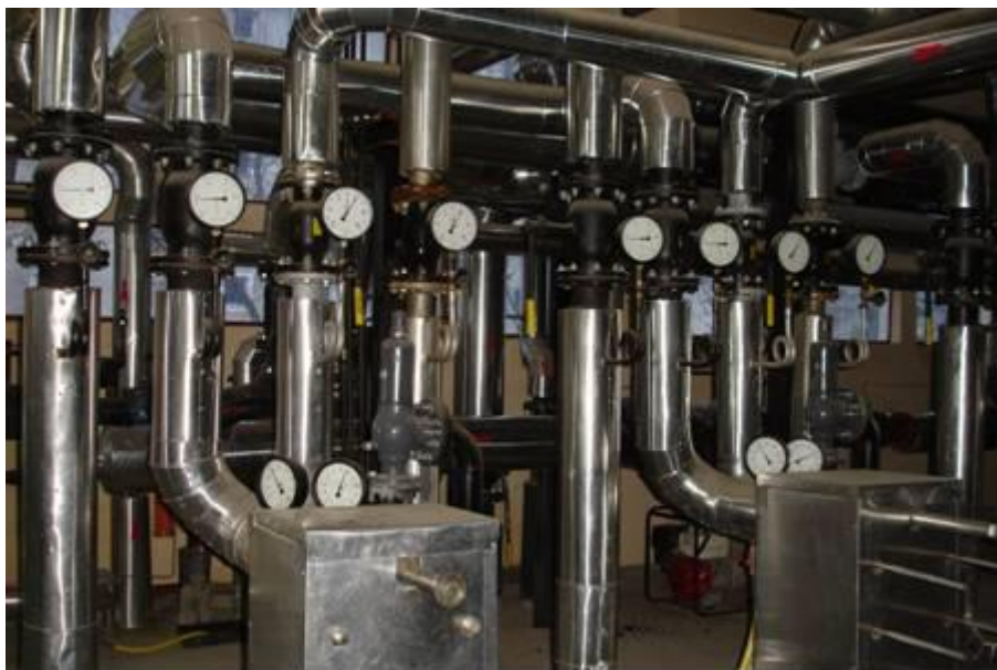
Figura 2.7. Starea echipamentelor/gradul de uzură al echipamentelor din PT1
