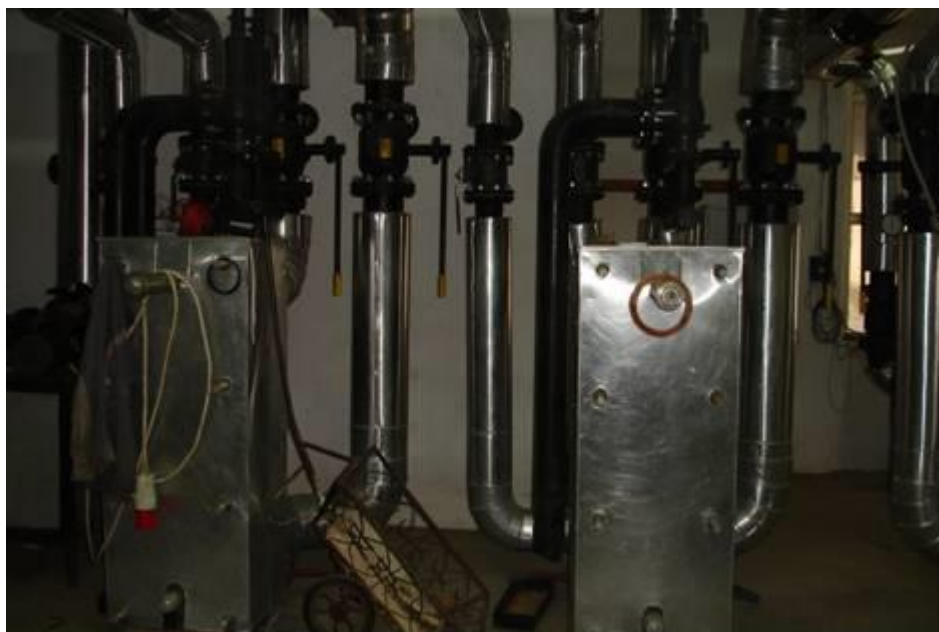
Figura 2.17. Starea echipamentelor/gradul de uzură al echipamentelor din PT4
