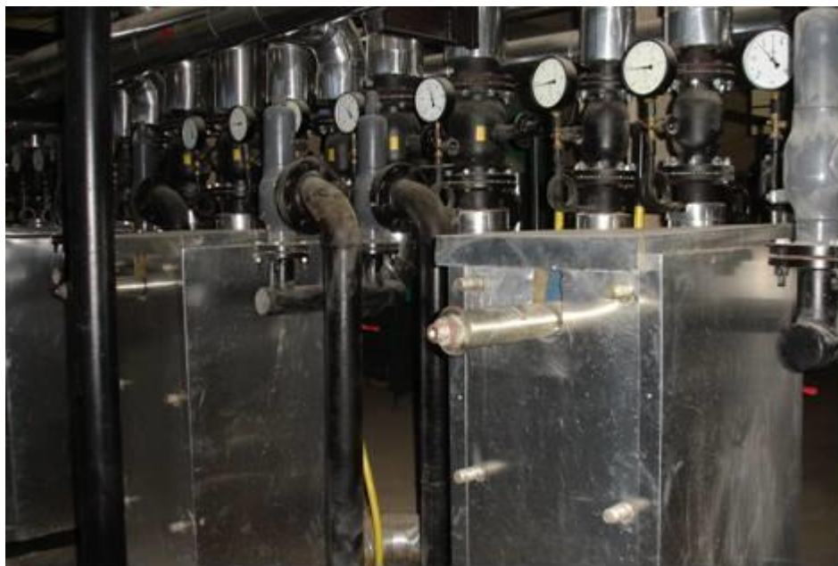
Figura 2.11. Starea echipamentelor/gradul de uzură al echipamentelor din PT2
