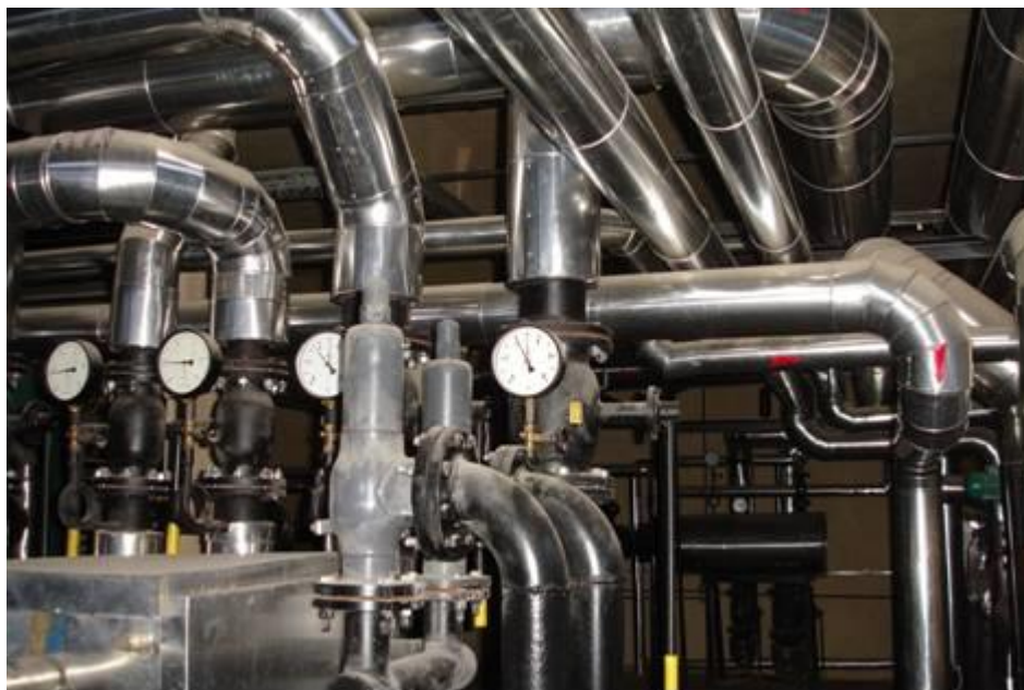
Figura 2.13. Starea echipamentelor/gradul de uzură al echipamentelor din PT2
