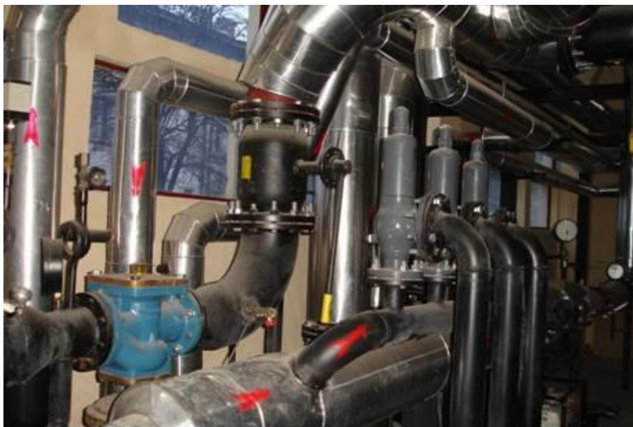
Figura 2.8. Starea echipamentelor/gradul de uzură al echipamentelor din PT1
