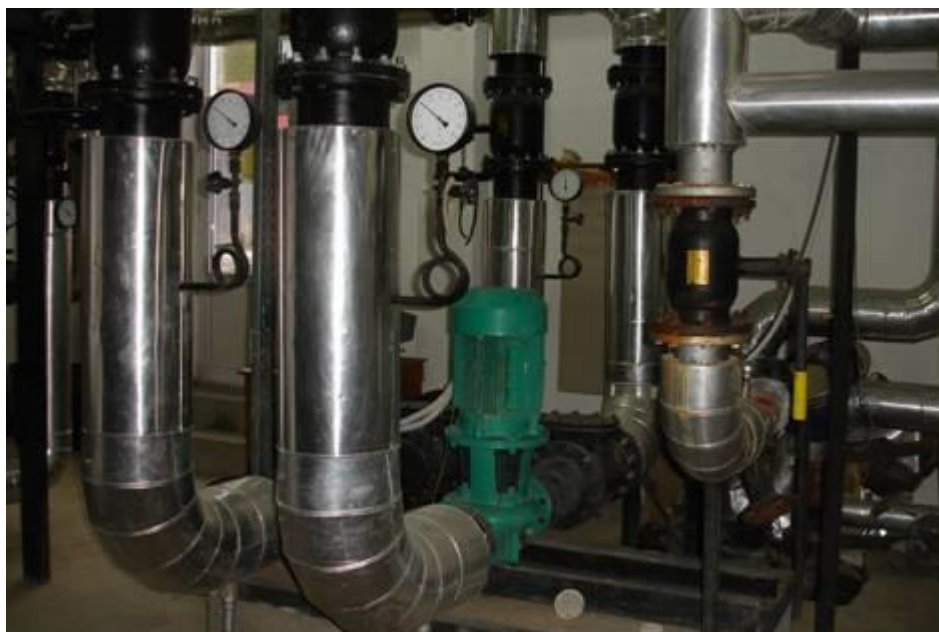
Figura 2.14. Starea echipamentelor/gradul de uzură al echipamentelor din PT3
